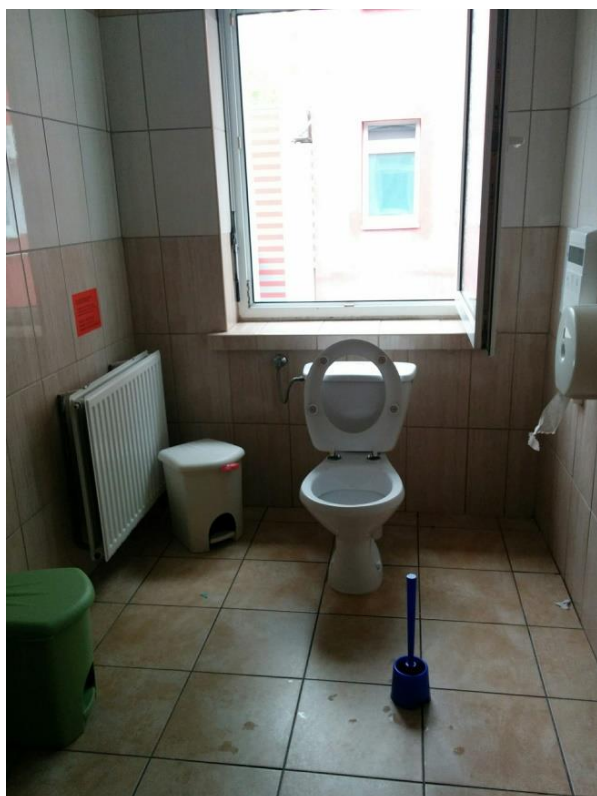
Zdjęcie nr 4. Toaleta niespełniająca standardów dostępności
